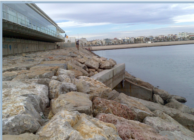
Imagen 9. Imagen del vertido/cauce.
