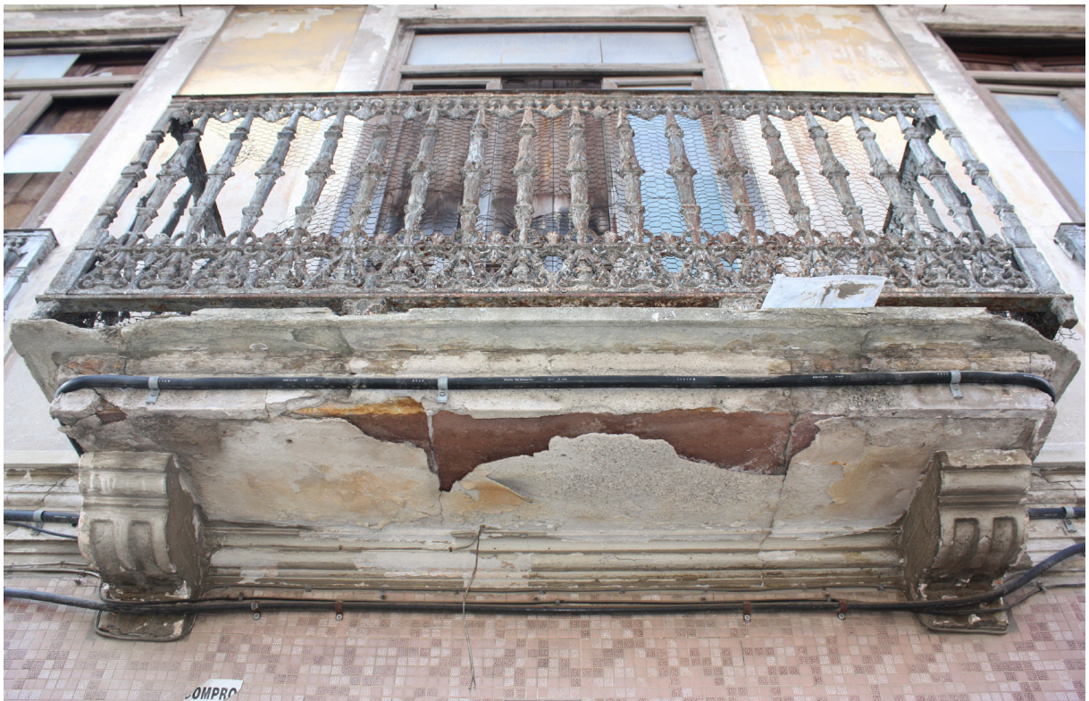
Figura 135. Detalle balcón sobre piezas de rodano en calle José Benlliure (Pastor, R. 2022)
