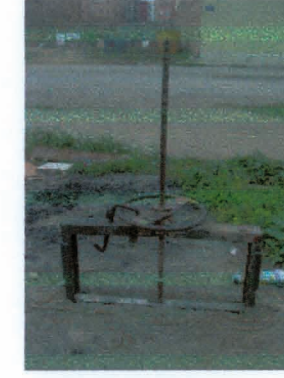
COMPUERTA Nº 03.b
