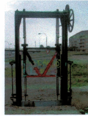
COMPUERTA Nº 03.a
