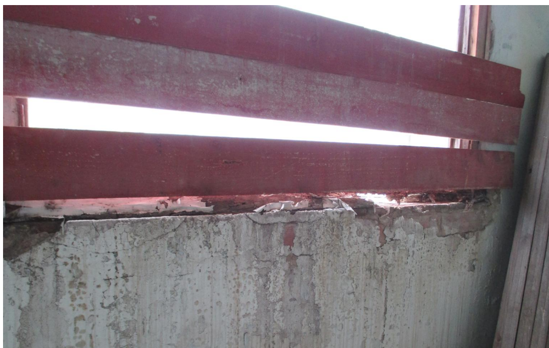
FOT-32 N° 3_Plaza Padre Domenech_ Filtraciones de agua de Lluvia
