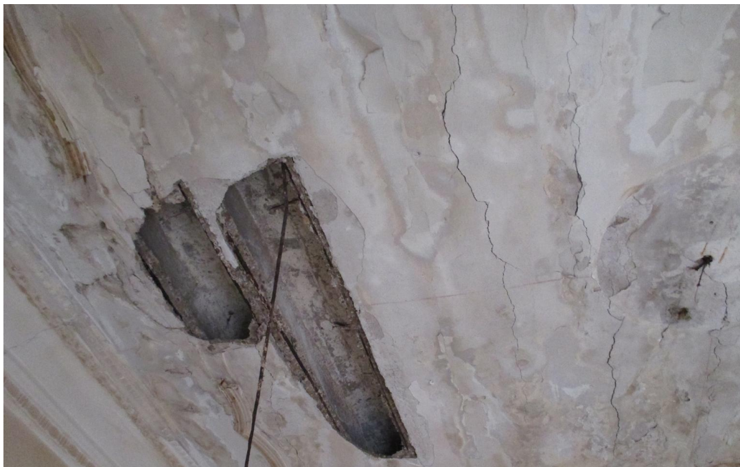
FOT-30 N° 3_Plaza Padre Domenech_ Forjados de Cubierta atacados por Filtraciones de agua de Lluvia_Extensible al resto de edificios
