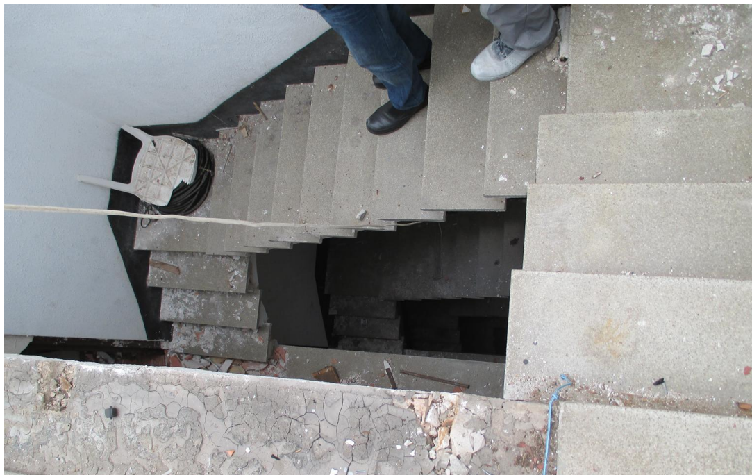
FOT-23 Nº 3_Plaza Padre Domenech_Escaleras sin barandillas_ Extensible al resto de edificios
