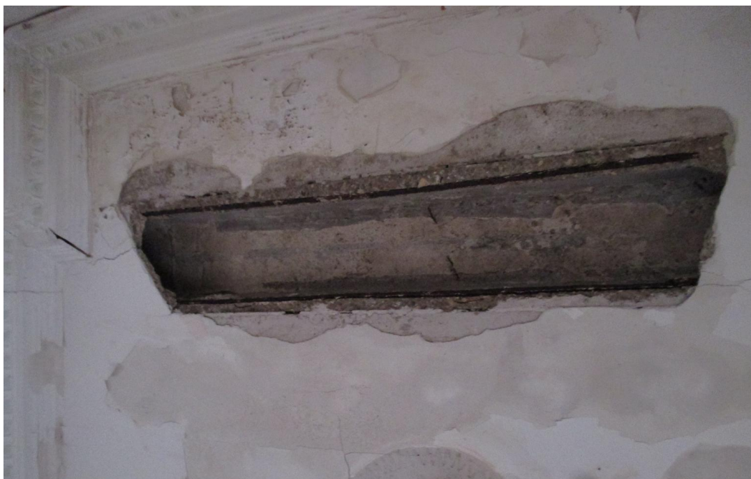
FOT-28 Nº 3_Plaza Padre Domenech_ Forjados de Cubierta atacados por Filtraciones de agua de Lluvia_Extensible al resto de edificios
