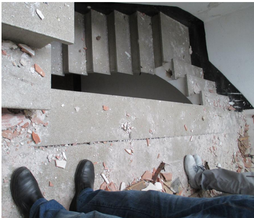
FOT-24 Nº 3_Plaza Padre Domenech_Peldaños sueltos_ Extensible al resto de edificios
