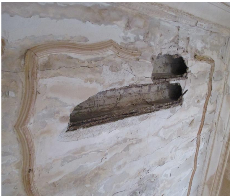
FOT-29 N° 3_Plaza Padre Domenech_ Forjados de Cubierta atacados por Filtraciones de agua de Lluvia_Extensible al resto de edificios
