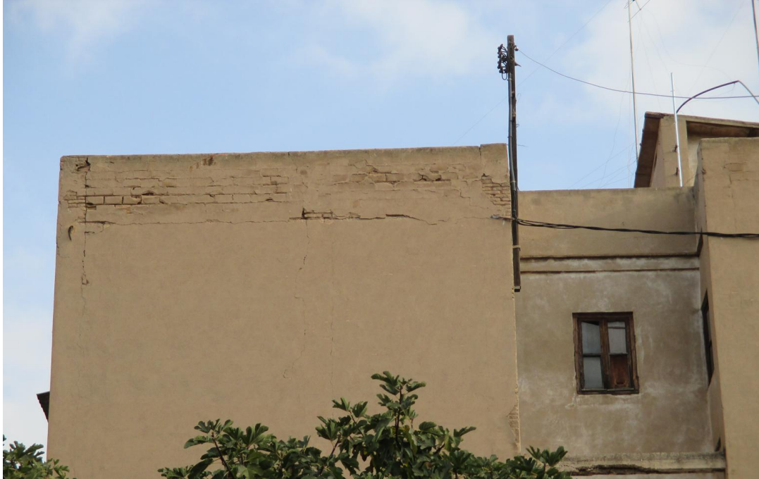
FOT-33 N° 8_Diego Mirón_Elementos sueltos en cubierta_ Extensible al resto
