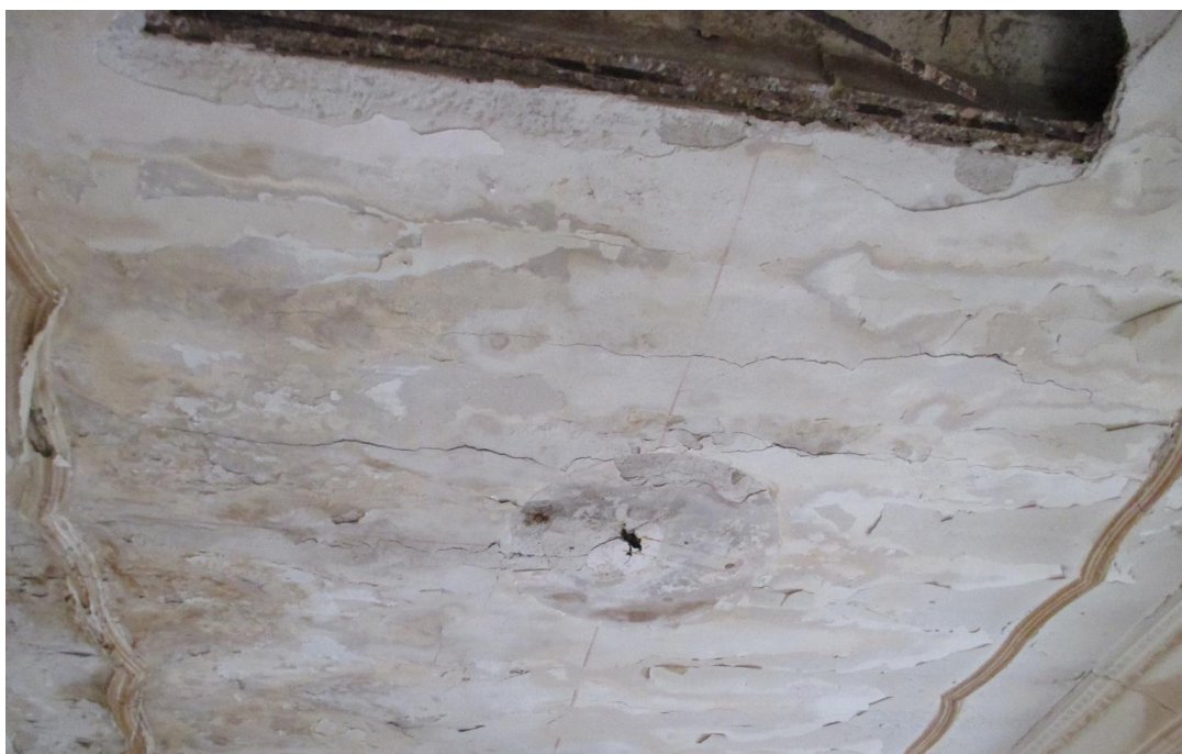
FOT-31 N° 3_Plaza Padre Domenech_ Forjados de Cubierta atacados por Filtraciones de agua de Lluvia_Extensible al resto de edificios
