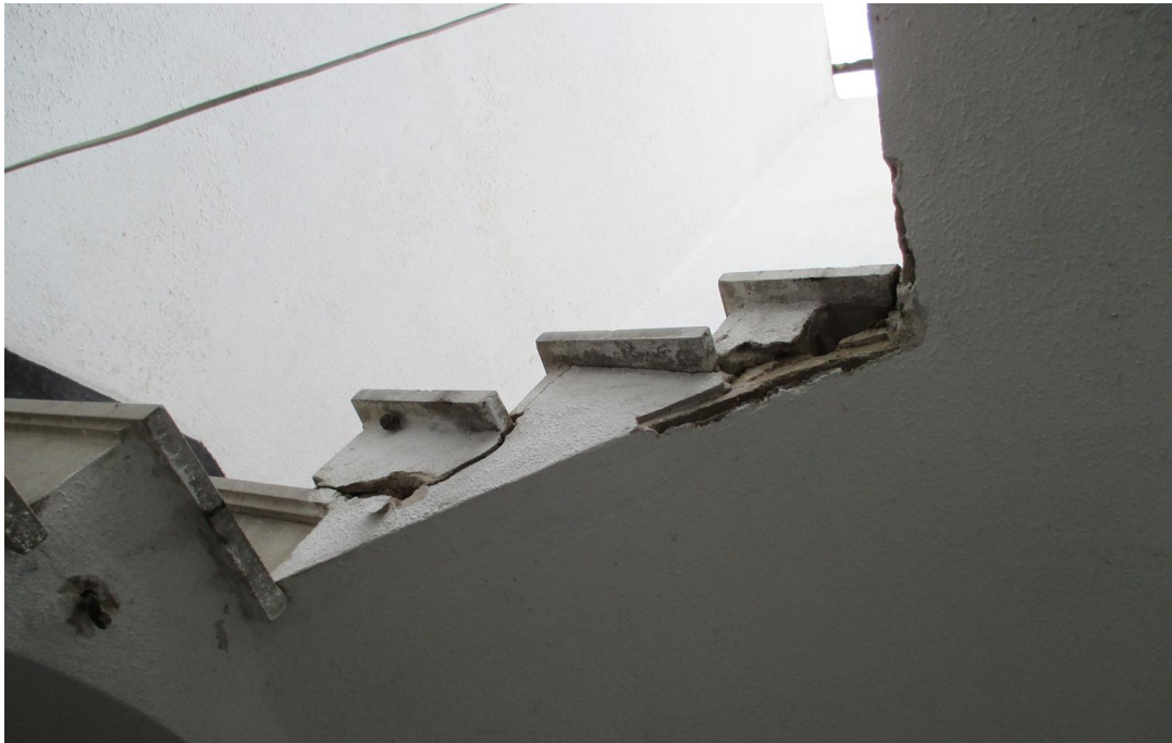
FOT-25 N° 3_Plaza Padre Domenech_Peldaños sueltos_ Extensible al resto de edificios
