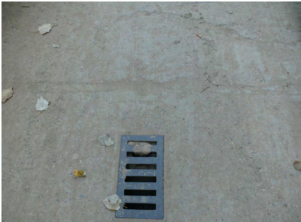
FOTO N°32: Imbornal existente en viario entre el jardín del límite SE y la edificación existente fuera del ámbito.
