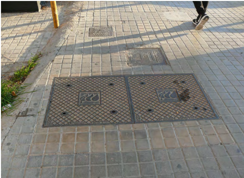
FOTO N°19: Arqueta de Iberdrola en la acera de la Avda. Tirso de Molina. .
