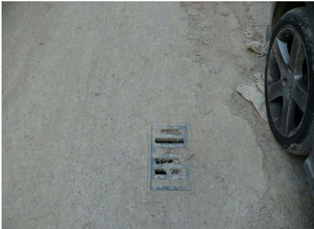
FOTO N°29: Imbornal existente en viario entre el jardín del límite SE y la edificación existente fuera del ámbito .
