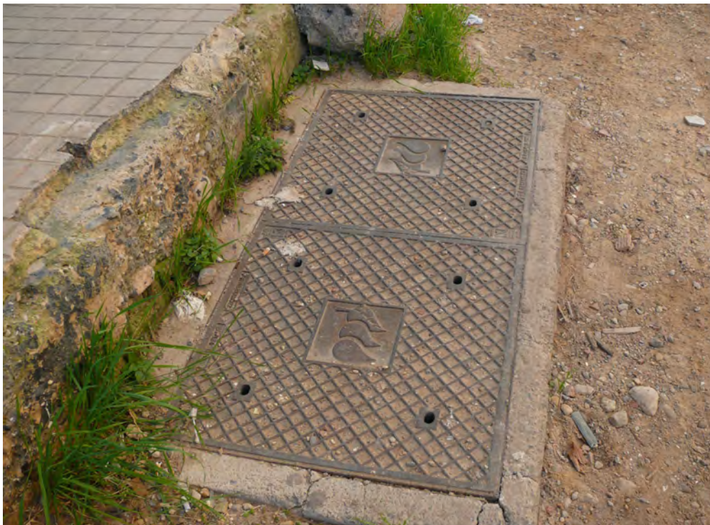
FOTO Nº14: Arqueta de Iberdrola en camino de tierras al sur de la actuación en proximidad al cruce con la Avda. Tirso de Molina
