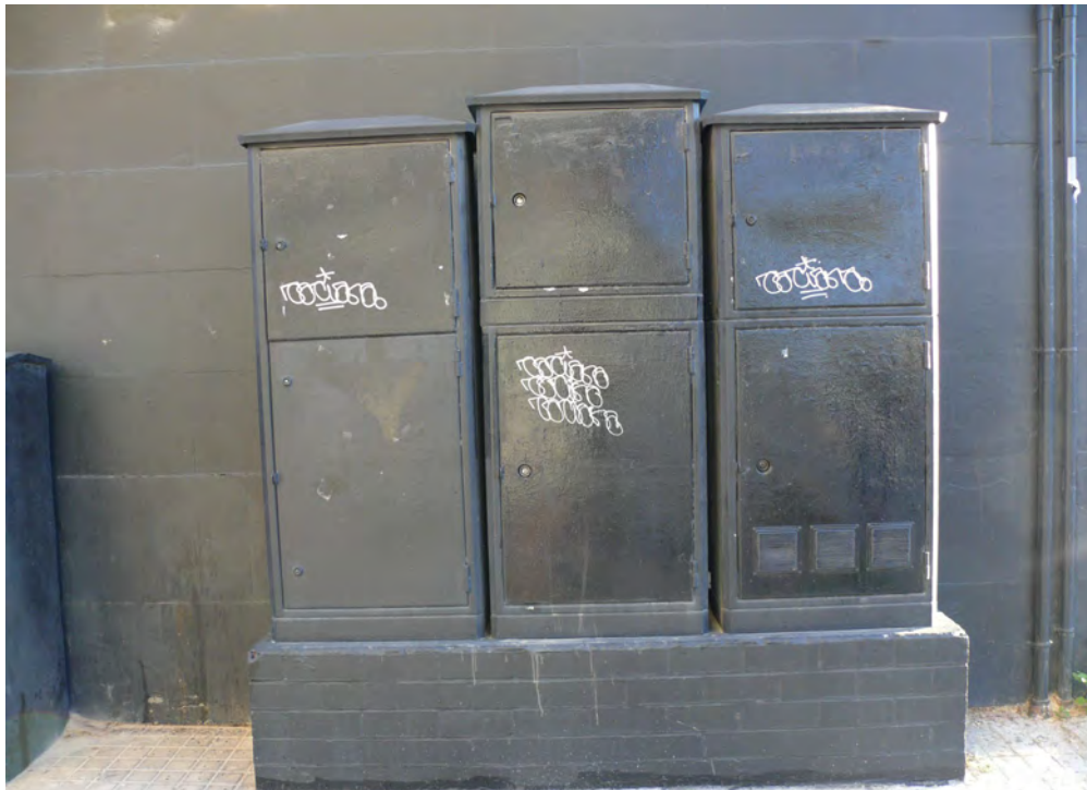
FOTO N°17: Armarios existentes en fachada del límite sur en inmediación a la intersección con acera de la Avda. Tirso de Molina.
