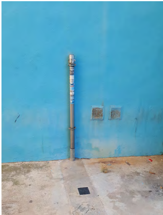
FOTO N°49: Poste y zanja de gas en C/ Padre Domenech, para gimnasio existente. .
