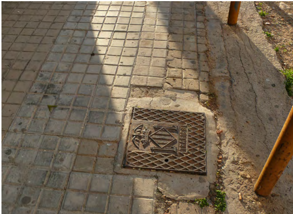
FOTO N°15: Arqueta de alumbrado en la acera de la Avda. Tirso de Molina .
