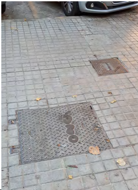
FOTO N°54: Arqueta de telefonía ONO.
